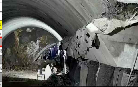
<그림 5. 터널 내부 붕괴> 출처: YTN
